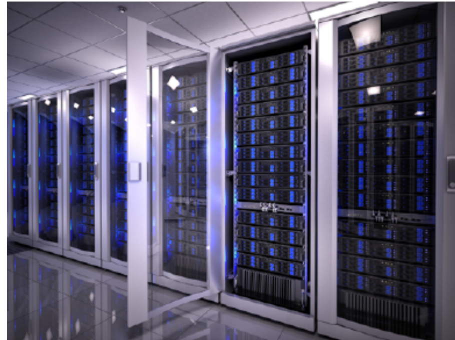
Server im Rechenzentrum
